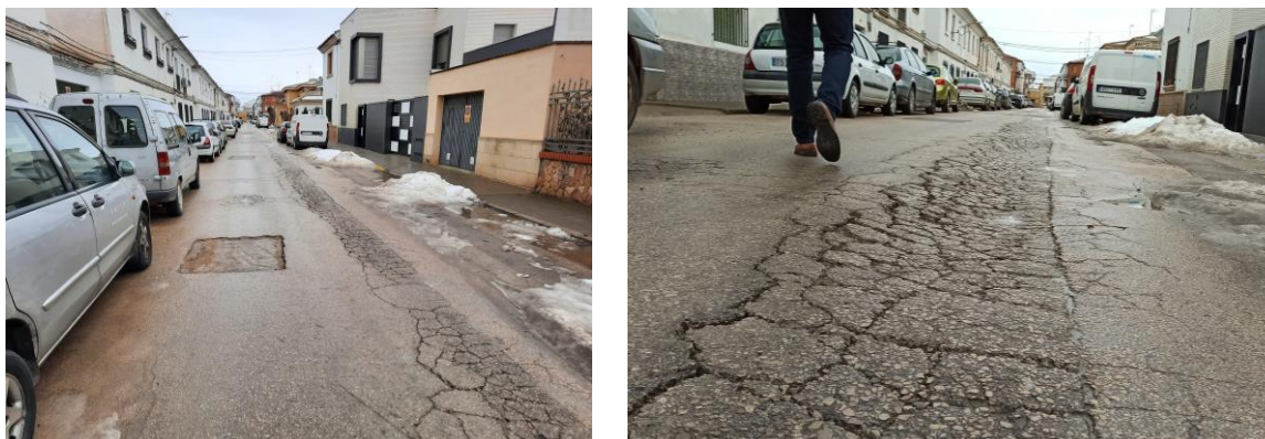
Imagen 2 Patologías de la calzada
